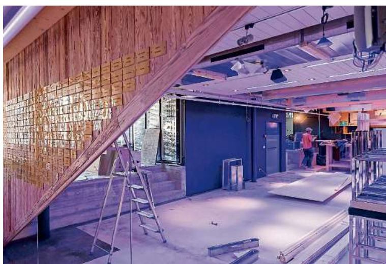
Im Inneren der Nordseite der Davoser Eishalle wird unter Hochdruck an der Sanierung gearbeitet. (FOTO YANIK BÜRKLI)
